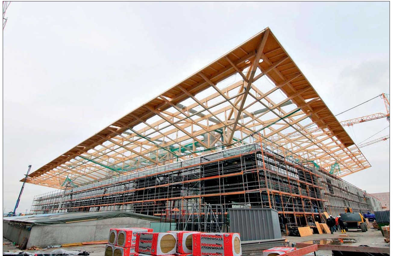
Das Vordach der Frankfurter Messehalle 11 kragt bis zu 26 m aus. Bei einer Traufhöhe von 30 m bietet es dem Wind einige Angriffsmöglichkeiten. Fotos: Wiehag (5), Messe Frankfurt (1)
