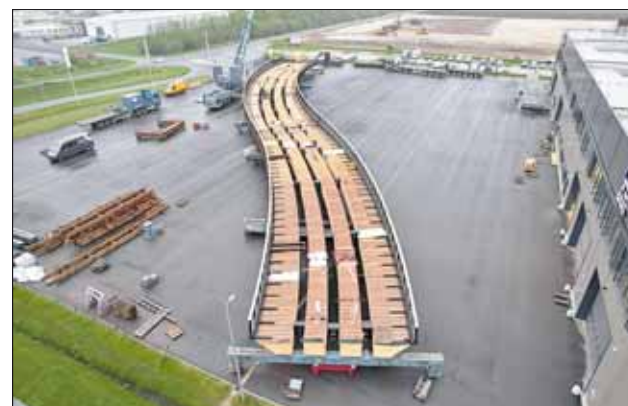
Um die geringen Toleranzen des 130 m langen Bauwerks zu gewährleisten, wurde die Hauptkonstruktion bereits im Werk zur Probe aufgebaut.
