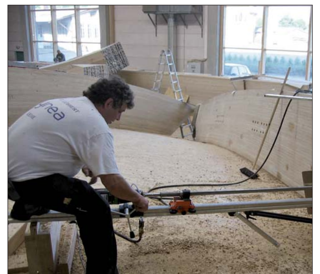
Mit der von Schaffitzel entwickelten Vorrichtung lässt sich das Bohrergerät exakt einjustieren.
