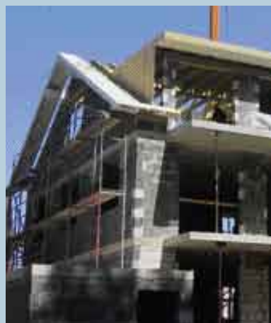
Bild links: Völlig ungesichertes Gebäude. Hier hätte der SiGeKo wohl viel zu tun
