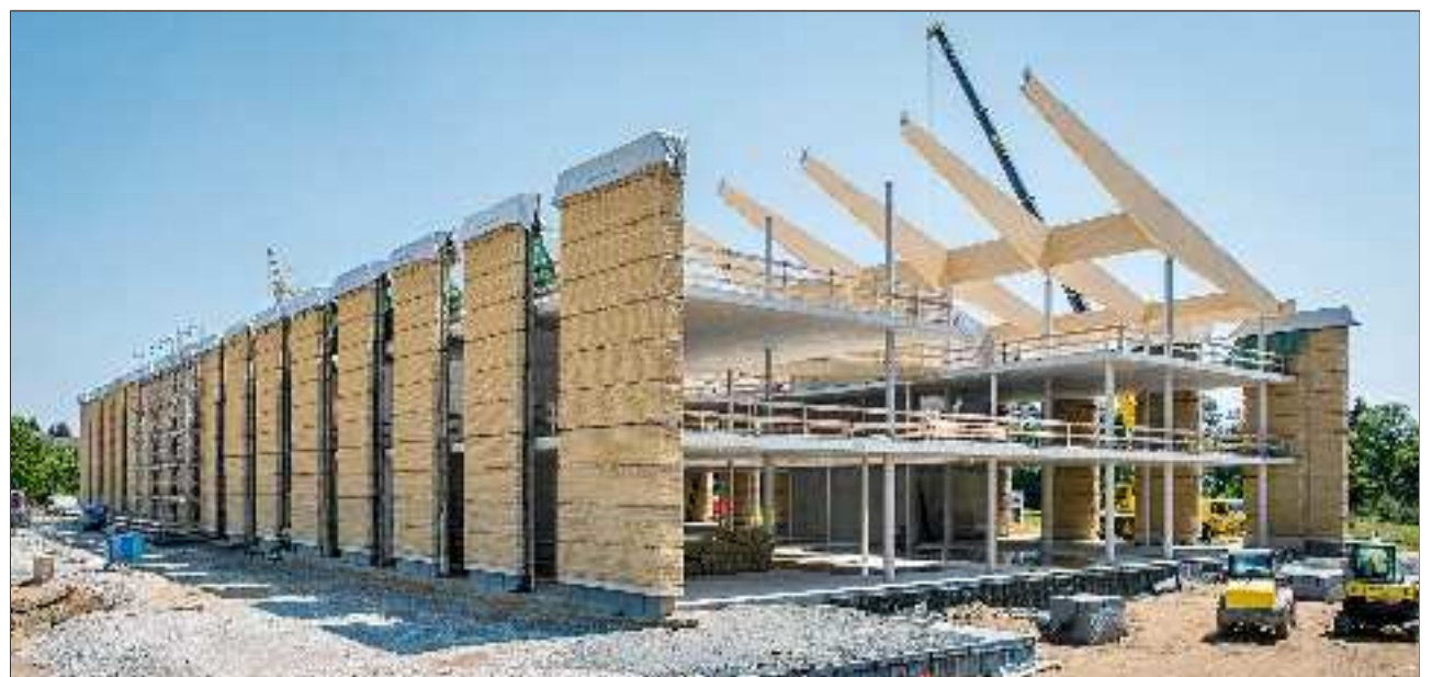
Decken und Stützen aus Beton sowie dicke Fassadenelemente aus Stampflehm dienen dem derzeit sich im Bau befindlichen Alnatura-Campus als Wärmespeichermasse, die das Gebäude im Sommer vor Überhitzung schützen soll. Foto: Alnatura
