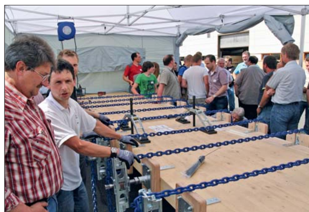
Die Schäftung wird an den Universal-Keilzinkenstoß angelegt (vgl. Foto links) und dann mittels eines Spannsystems aus Zugketten mit den beiden Brettschichtholz-Teilträgern verklebt.
